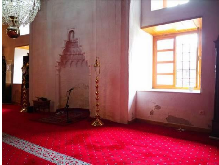
İç mekanda sıva ve boyada izlenen kabarma ve dökülmeler (Görsel: BAYKAL Pınar, Kültür ve Turizm Bakanlığı, 2021)
