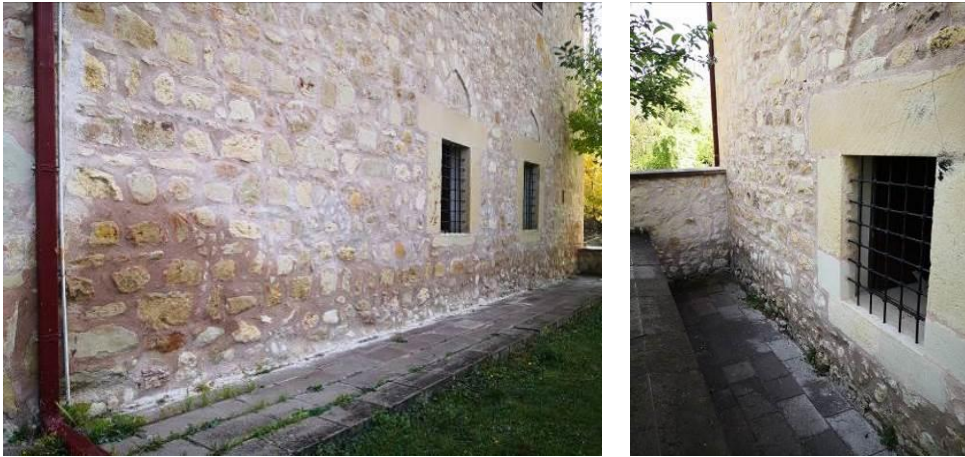
Batı ve doğu cephelerde neme bağlı malzeme bozulmaları, 2021 (Görseller: BAYKAL Pınar, Kültür ve Turizm Bakanlığı)
