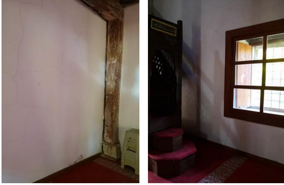
Batı Duvarındaki sıva-boya dökülmeleri ve ince çatlaklar (Görseller: BAYKAL Pınar, Kültür ve Turizm Bakanlığı)
