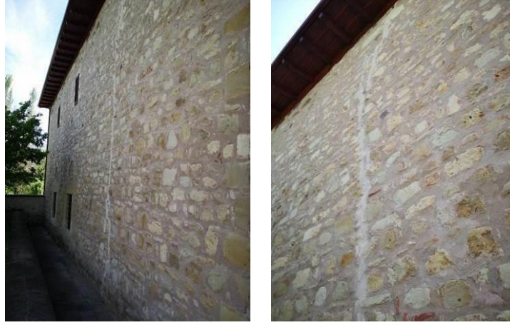
Doğu cephe duvarındaki çatlak oluşumu, 2021 (Görseller: BAYKAL Pınar, Kültür ve Turizm Bakanlığı)
